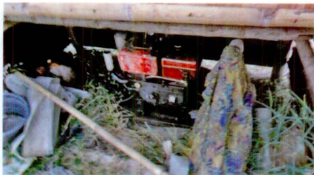
Foto 21. Diesel Untuk Memompa Air Dari Mata Air.
